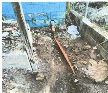
Foto 3: Red de Drenaje
